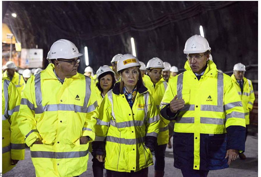
La ministra de Foment, Ana Pastor, acompanyada de polítics gallecs del PP, visita les obres del túnel d'O Espiño per on ha de passar la línia d'AVE Madrid-Galícia, inclosa en els PGE del 2015.
