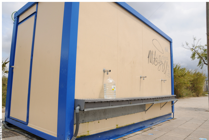
Una de les fonts d'osmosi inversa que s'han instal·lat a Alzira.
