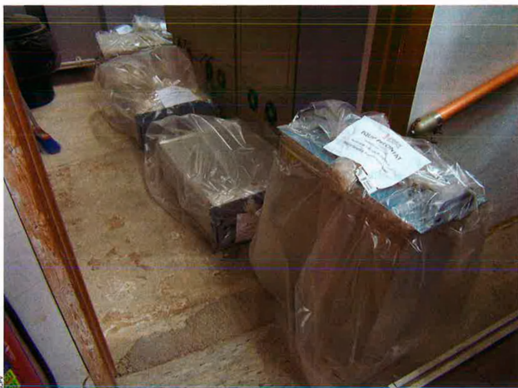
Aparells precintats a les instal·lacions del repetidor de la Carrasqueta.
