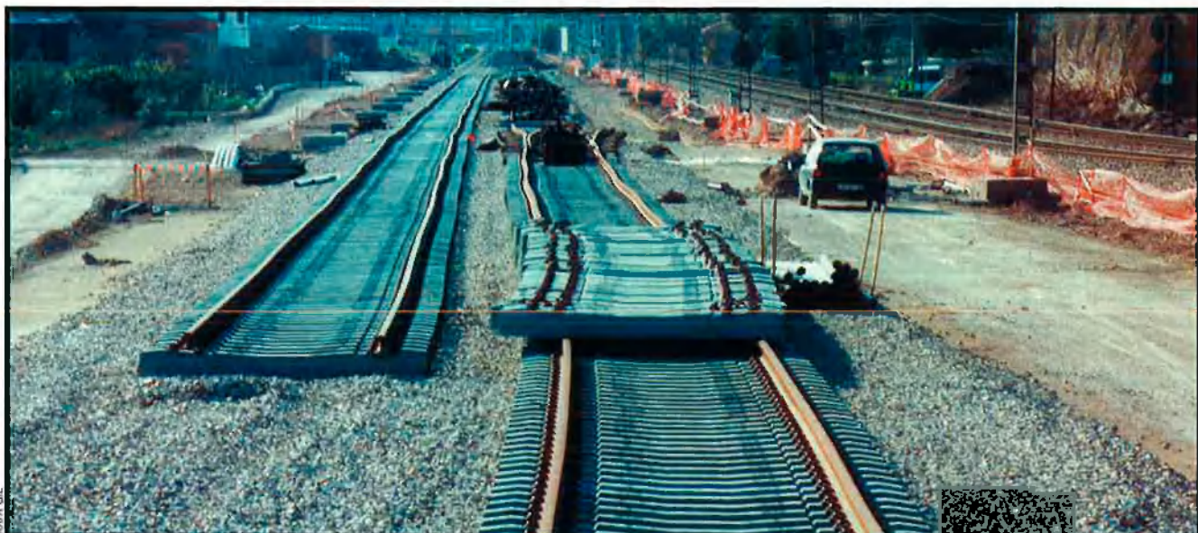
Imatge de l'accés ferroviari al Port de València en ample ibèric i travessa polivalent. Els directors dels ports de Barcelona i de Tarragona creuen que la instal·lació valenciana hauria d'haver reclamat l'ample internacional.
