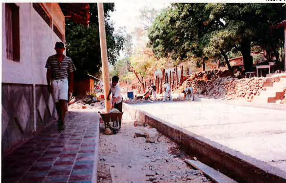
Procés de pavimentació d'un carrer al poble de Cinco Pinos. La corrupció ha fet que no arribi tota la subvenció necessària per a fer aquesta obra i així s'ha reduït a 6 metres deixant un tros sense fer-hi res.
