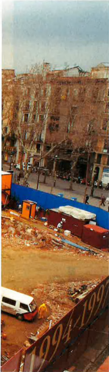
Panoràmica actual de les obres de reconstrucció del Gran Teatre del Liceu. Es tracta d'una obra contra rellotge i qualsevol entrebanc, per petit que sigui, la pot desequilibrar.
