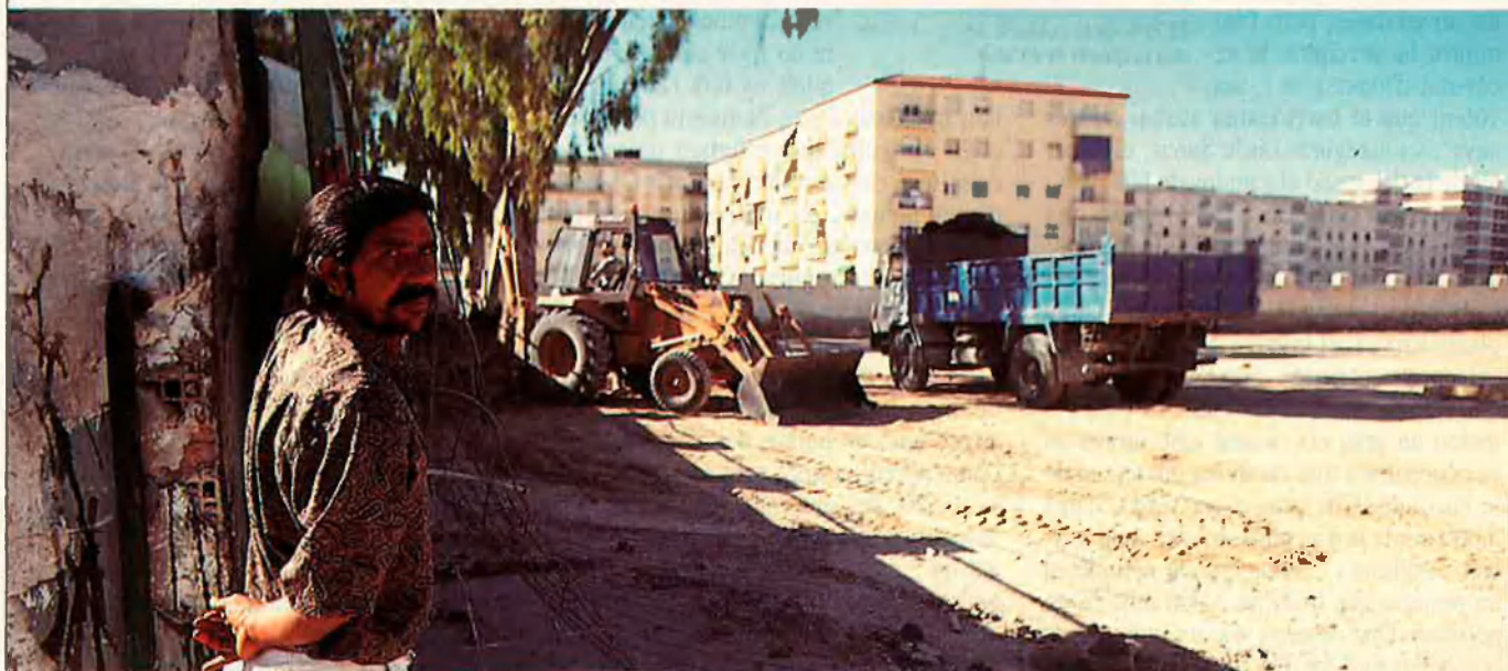
Les obres de reconstrucció del barri de les Mil Vivendes ja han començat.
