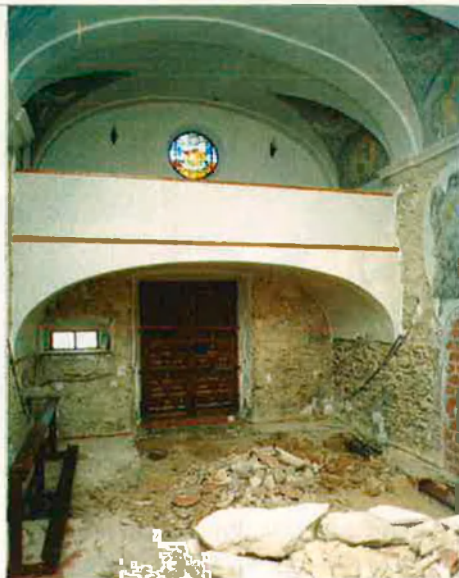
Destrosses a l'interior del santuari: l'escala que portava al cor ja no hi és ni tampoc els bancs que s'aprecien a la fotografia.
