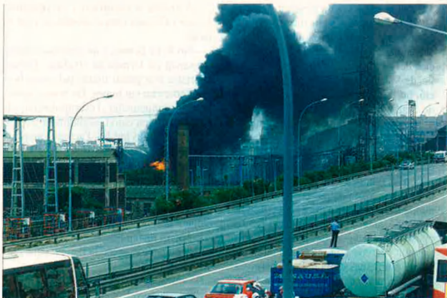
L'incendi provocat per un llamp en un transformador barceloní ha posat en evidència les greus mancances de la xarxa de distribució elèctrica al nostre país.
