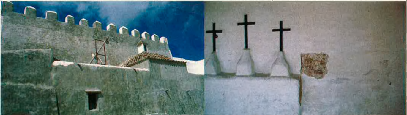
Esquerra, lateral de la mateixa església de Sant Jordi, completament tapat de ciment. Dreta, les creus del calvari al porxo; devora comencen a picar.
