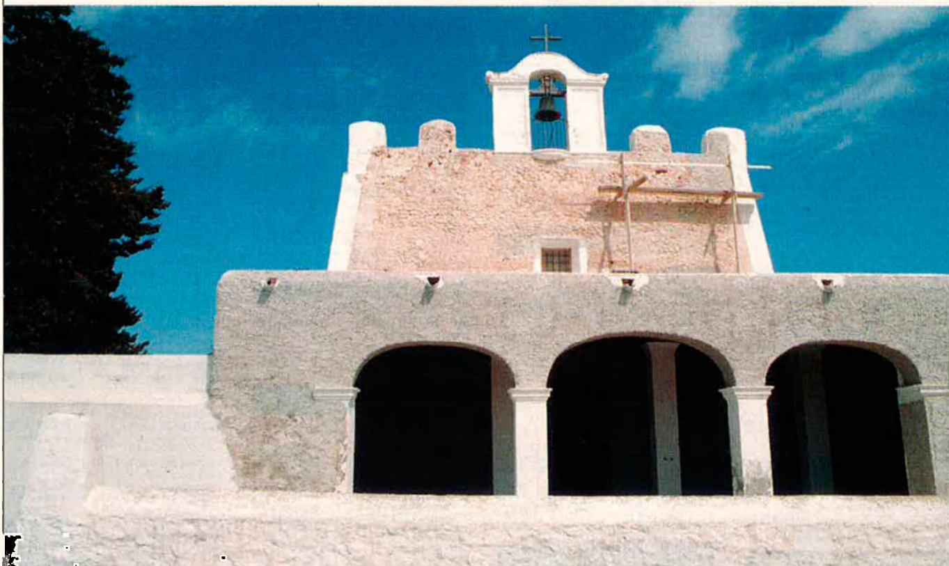
Façana principal de l'església de Sant Jordi. La part de dalt sense calç, amb les pedres a l'aire. La part del porxo ja recoberta de ciment.
