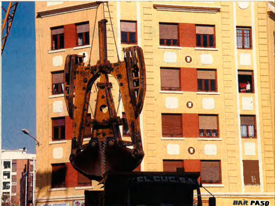
Les obres del metro han posat potes enlaire els barris perifèrics de la ciutat.
