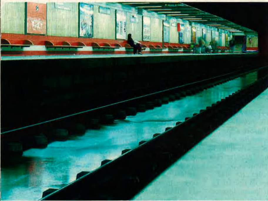
La Conselleria d'Obres Públiques assegura que aquesta vegada no hi ha filtracions d'aigua, com va passar en la construcció de les línies 1 i 2 a l'estació d'Angel Guimerà.
