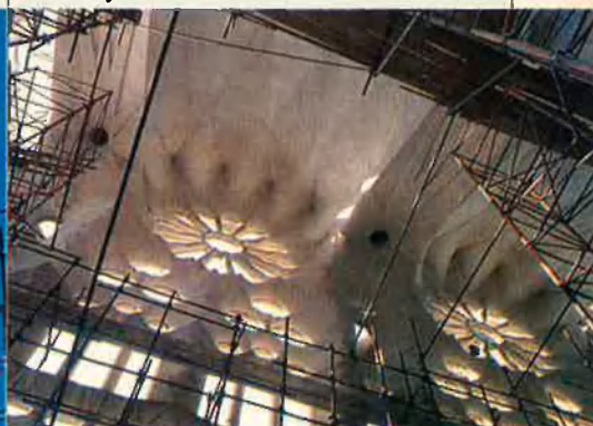
A l'esquerra, panoràmica de la Sagrada Família amb les noves columnes que en sustentaran la nau central. Dalt, voltes de la cantoria, recentment acabades.
