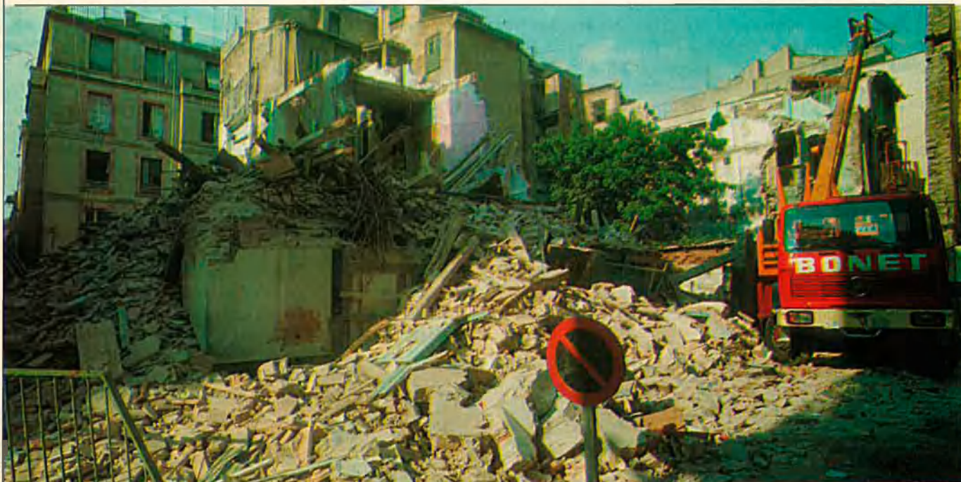
En l'actualitat, vora el 70% dels edificis del barri del Carme necessiten una intervenció immediata.
