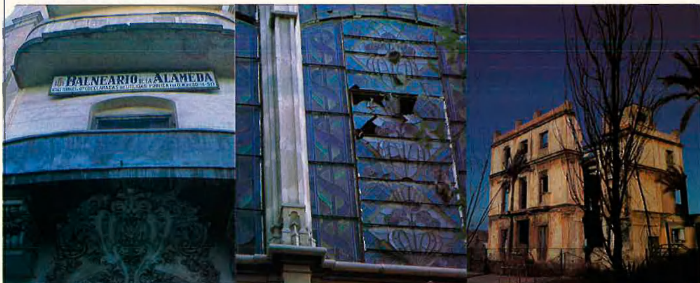
A l'esquerra, façana del balneari de l'Albereda; al centre, vidrieres trencades al Palau de l'Exposició; a la dreta, restes del xalet de Blasco Ibáñez abans de ser enderrocat totalment.
