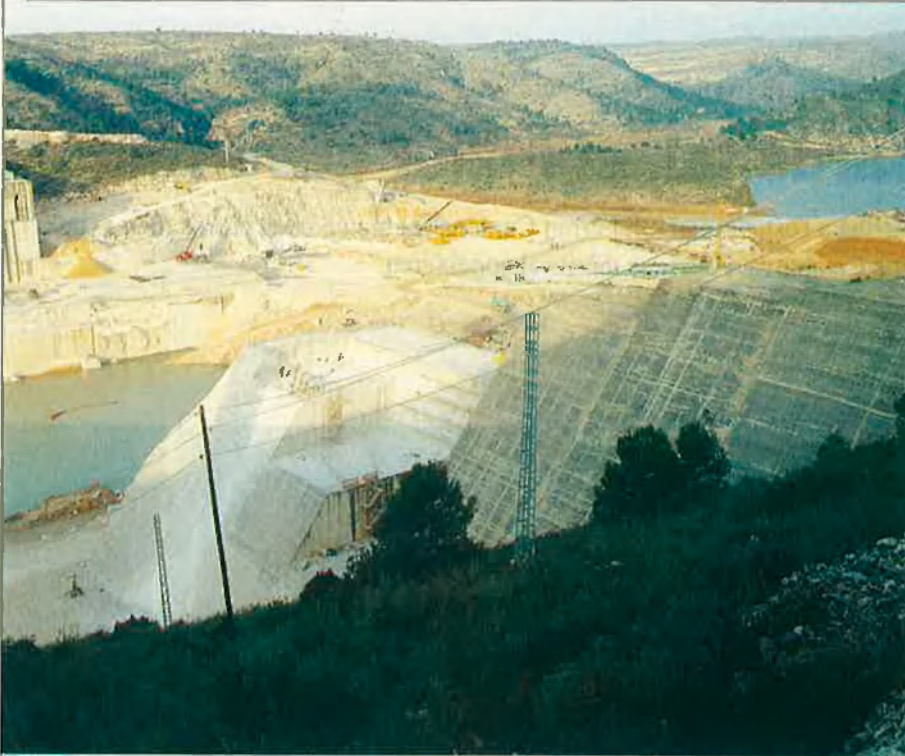
Les discrepàncies en la interpretació tècnica del projecte poden provocar la paralització total de les obres.
