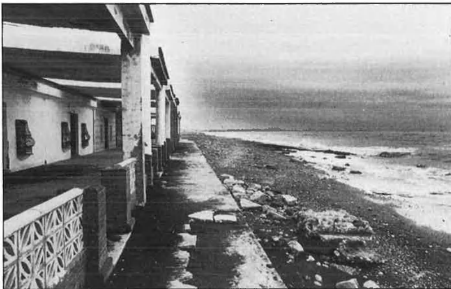
Les casetes de la platja de Puçol tenen signat el decret d'enderrocament.
