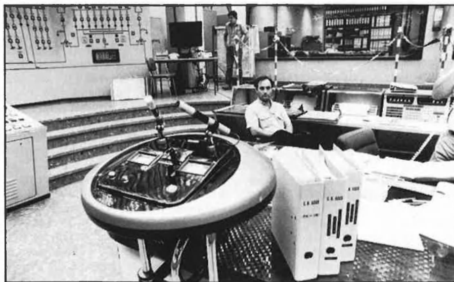
Vistes exteriors i interiors de la central Ascó-II.
